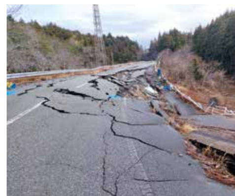
大きくゆがんだ道路
